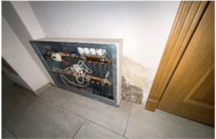
Abb. 10: Foto des SV; Fußbodenheizung schadhaft, Leckage (UG)
