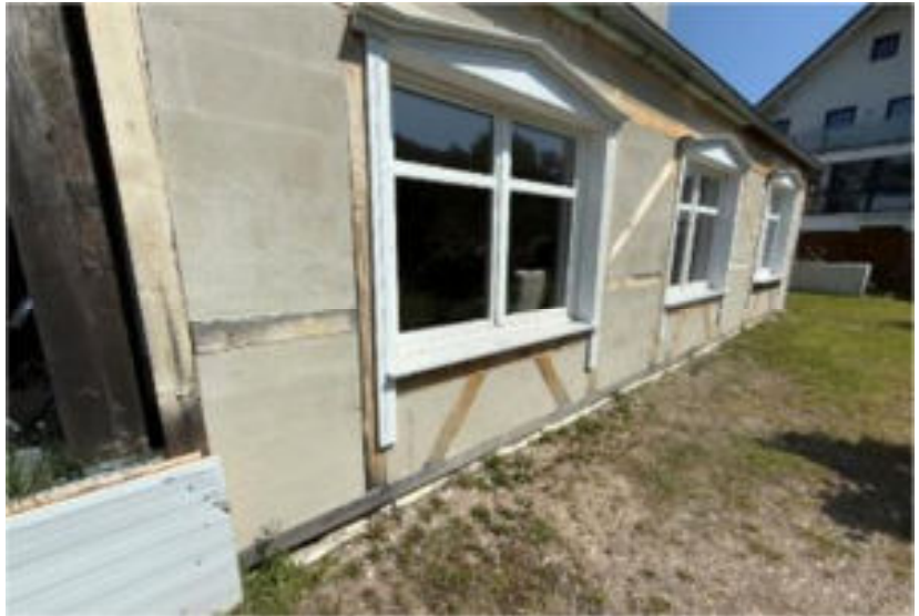
Abb. 4: Foto des SV; z.T. Fassade nicht fertiggestellt
