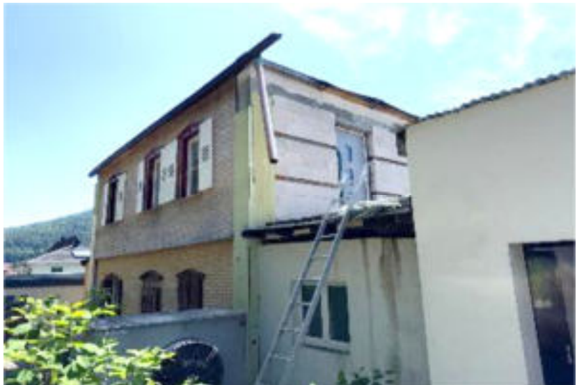
Abb. 5: Foto des SV; rohbaulicheres OG o. wirksamen Dachabschluss
