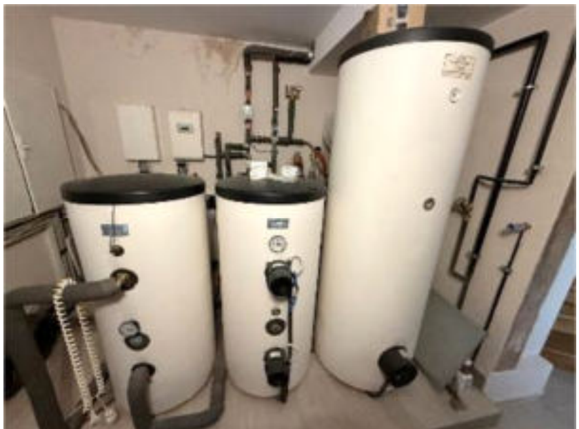
Foto 12 des SV: Wohnung 1 (UG), Technikraum
