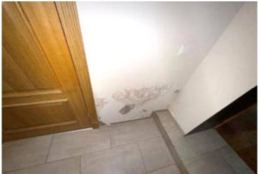
Abb. 11: Foto des SV; Feuchteschäden aufgrund Leckage der Fußbodenheizung (UG)
